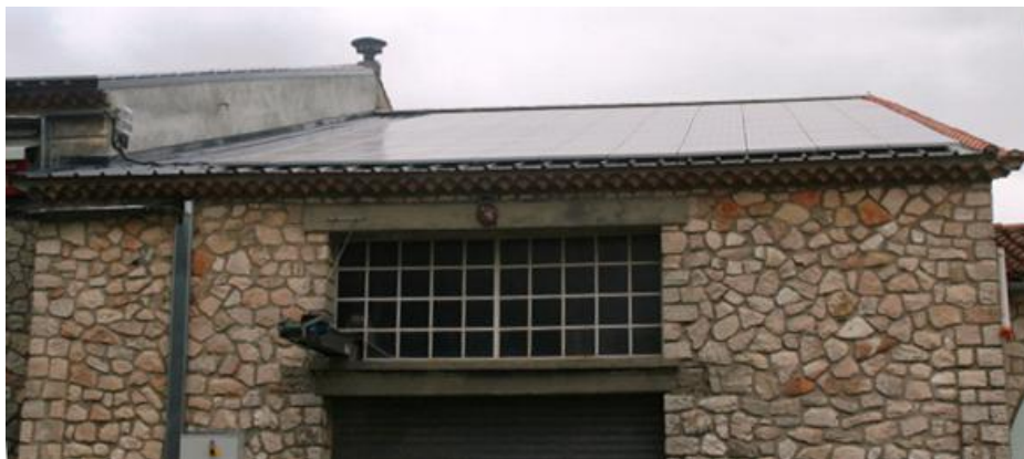
Figure 3 : Panneaux photovoltaïques (Lieu : Cave coopérative les Coteaux du Pic à Pic Saint-Loup)
