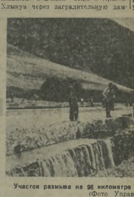
Участок размыва на 96 километре Военно-Грузинской дороги. (Фото Управления шоссеиных дорог Грузии).
