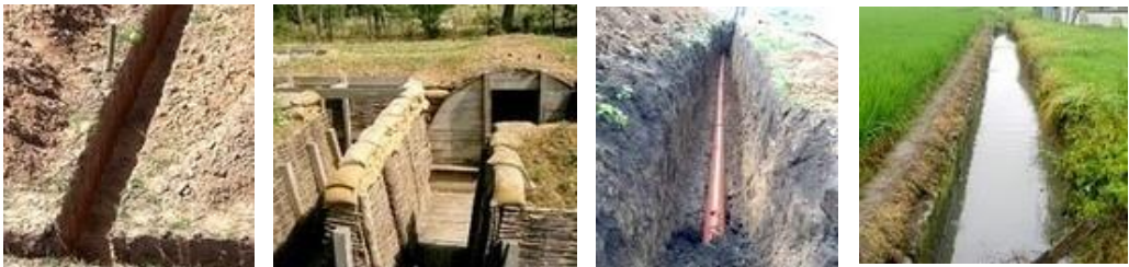
სურ. 2.6. თხრილის (ტრანშეის) სახეები: ა-ლენტური საძირკვლის მოსაწყობად; ბ-სათავდაცვო; გ-მიწებისა და კაბელების ჩასაწყობად; დ-სადრენაჟო
