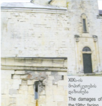
XIX-ის მოპირკეთების დაზიანება The damages of the 19thc. facing
