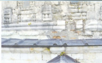
გუმბათის კვლის დაზიანება Damages of the Drum
