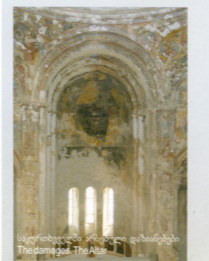
საკრიზიხვედში არსებული დაზიანებები The damages. The Altar
