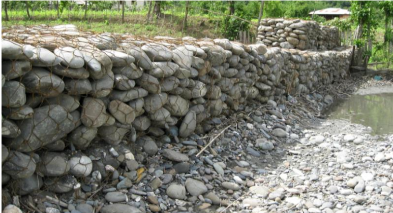
ფოტო 84. წყალდიდობის საწინააღმდეგო ქვის დეზების საერთო ხედი Photo 84. General view of the stone spurs against floods Фото 84. Общий вид каменных шпор для борьбы с наводнениями
