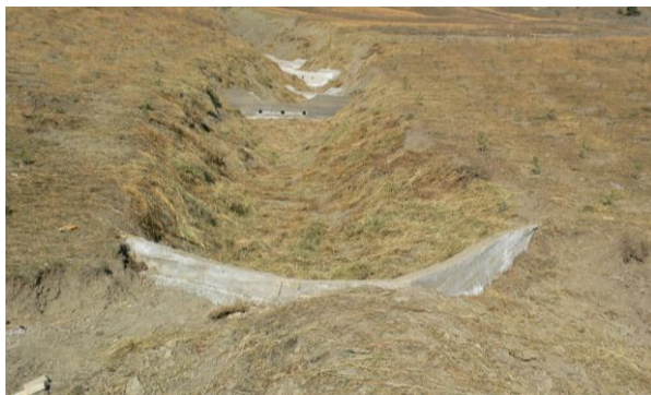
ფოტო 77. ბარაჟების ხედი ქვევიდან ზევით Photo 77. Barrage view from the bottom to the top Фото 77. Вид барражей снизу вверх
