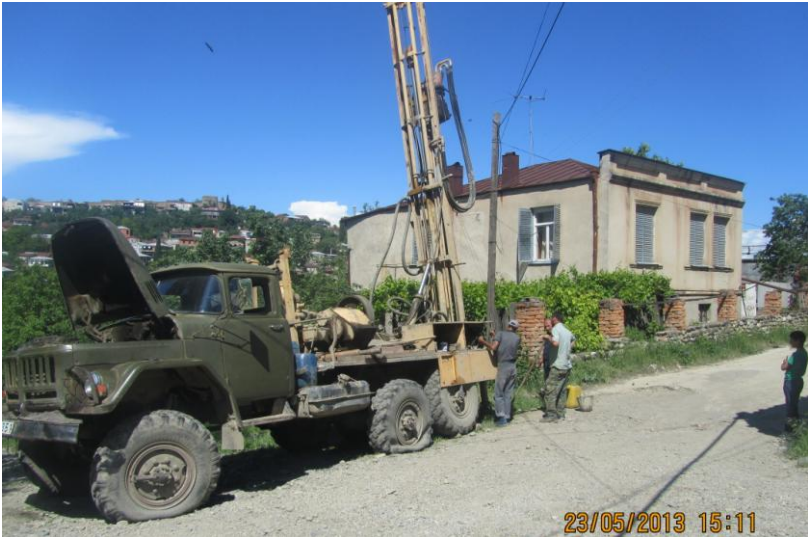
ფოტო 85. დამეწყრიღ ტერიტორიაზე შურფების მღწყობისას Photo 85. In the process of arranging the pits on the landslide territory Фото 85. Устройство шурфов на оползневой территории
