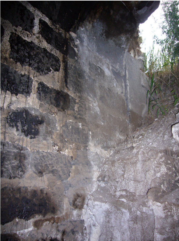
Resim 12: Kilise ile koridor duvarının oluşturduğu dilatasyon
