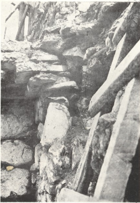
ბიოტური ეროზიის შედეგად გამოწვეული ვაჩნაძიანის „უველაწმინდის“ ეკლესიის ნაგებობის ნგრევა, პზარები და შემაკავშირებელი ნაწილის დაშლა.
