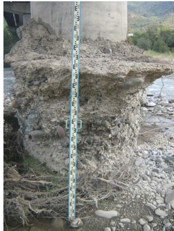
Фото 1. Одна из размывых опор существующего трубо-моста близ Натахтари
