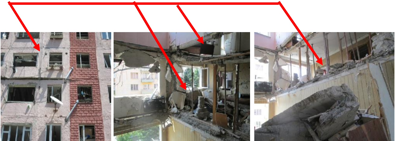
სურ. 5. ბუნებრივი აირის აფეთქების შედეგად დაზიანებული №2 საცხოვრებელი კორპუსის IV სადარბაზოს მე-4, 5, 6, სართულების მდგომარეობა
