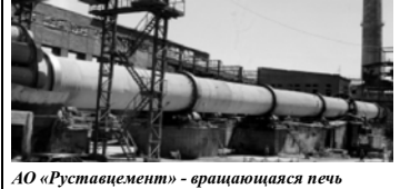
АО «Руставцемент» - вращающаяся печь
