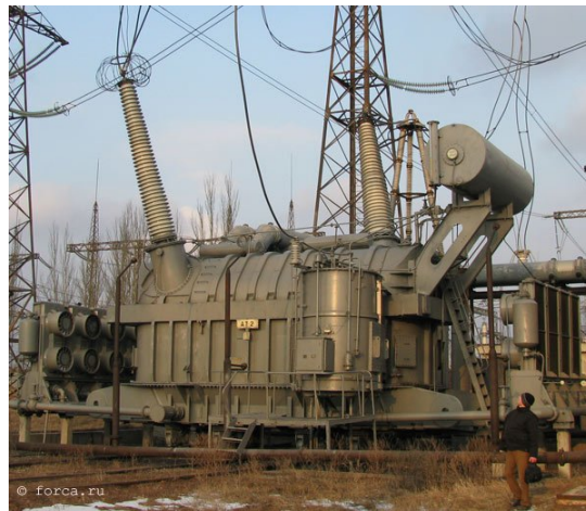
Nax.1.6. avtotransformatoris saerTo xedi
