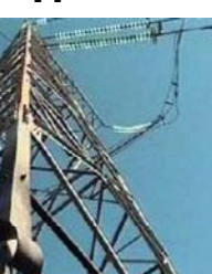
Вышка высоковольтной линии электропередачи в Абхазии.
