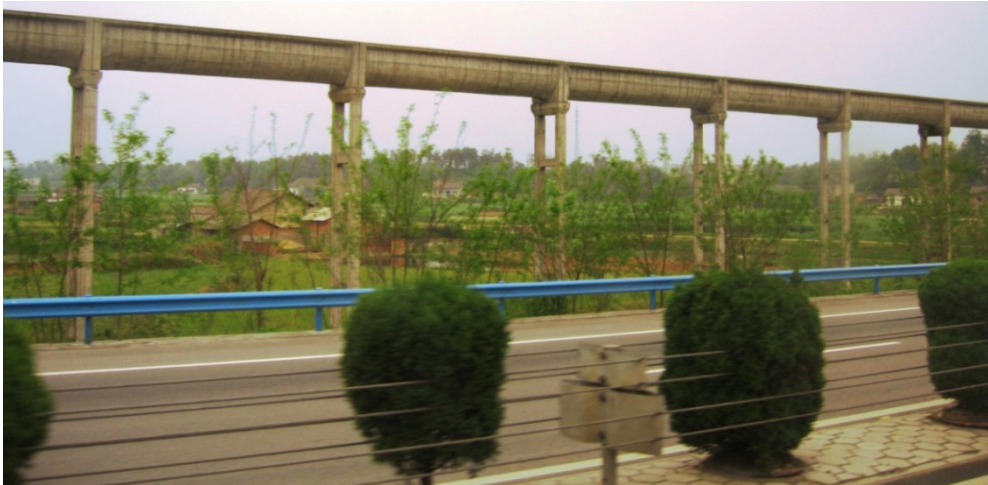
სურ. 6.1 აკვედუკის საერთო ხედი (ცენტრალური ჩინეთი, ჰუბეის პროვინცია, ავტორის ფოტო. 2014 წლის 1 ივნისი)
