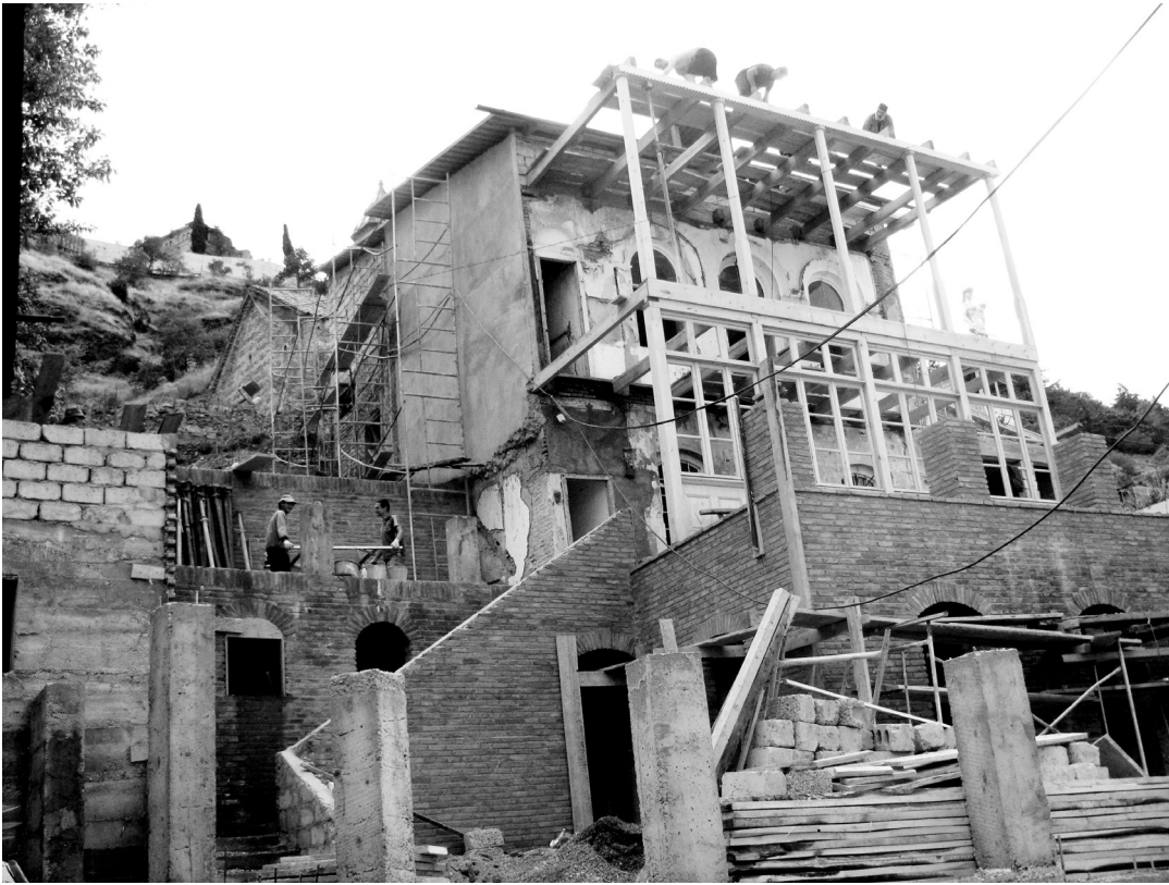
11. გომის ქ. №13. ტრანსფორმაცია-რეაბილიტაციის პროცესი Transformation of a house in a rehabilitation process. 13, Gomi Street.
