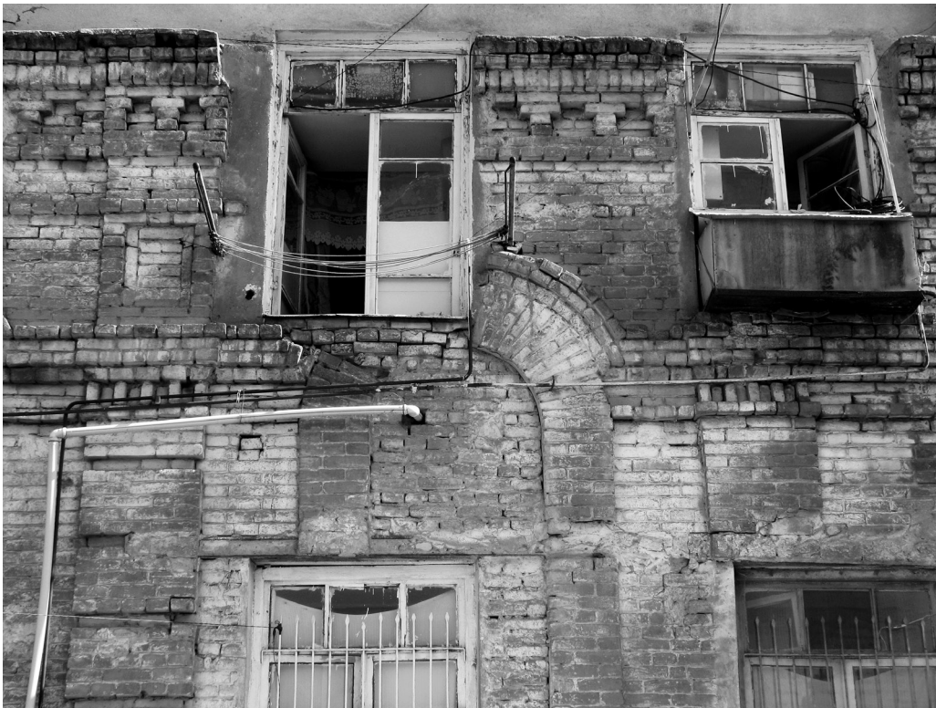
8. ყოფილი წმ. მიქაელ მთავარანგელოზის ეკლესია. სამხრეთი ფასადი. ფრაგმენტი The former Church of St. Michael the Archangel. South Façade Fragment
