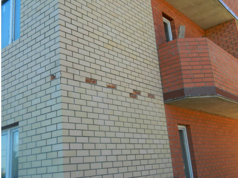
Рис.2. Разрушение материала кирпичной кладки стены фасада в уровне перекрытия
