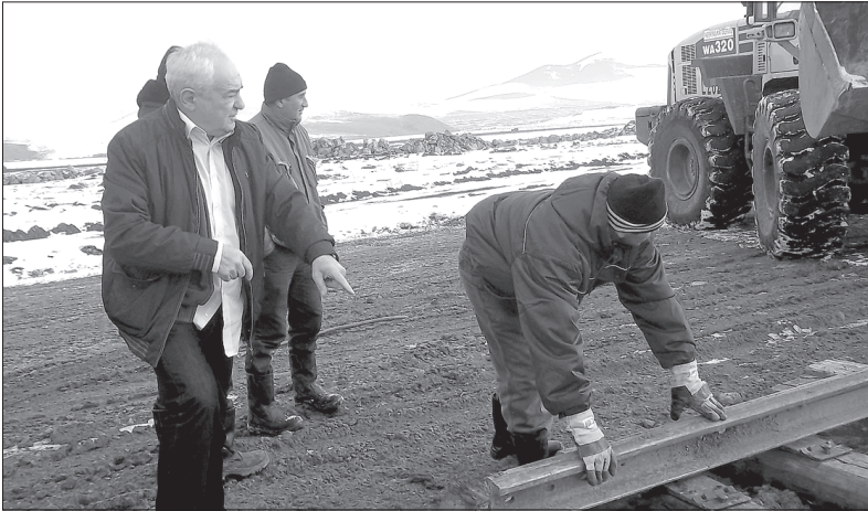
„ბურლაკები ვოლგაზე“ აგებენ რელსებს შპალეზზე. მშენებლობის უფროსის გამოცდილი თვალი მაინც ამჩნევს მილიმეტრებით გადახრას
