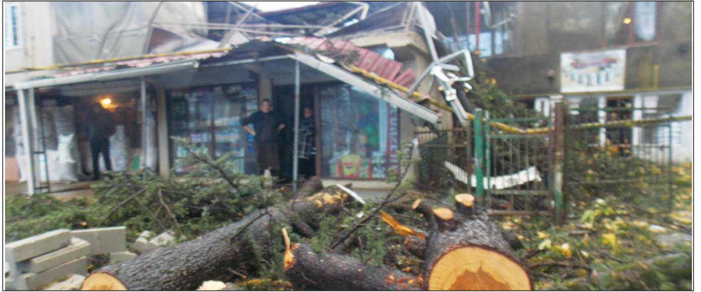
დაზიანებულია მაღაზიის სახურავი. საცხოვრებელ სახლში შესასვლელი კიბე. ხედავთ, ბუნებრივი აირის ხაზიც დაზიანებულია. - გვითხრა მან. ხის წაქცევის გამო თაყაიშვილის ქუჩაზე მოძრაობა ოზურგეთის მუნიციპალიტეტის ტერიტორიაზე შეფერხებული იყო. ძლიერი ქარის შედეგად,
