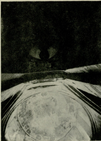
Свод в трехчетвертной нише и переход на углу от квадрата к кругу купола снизу.
