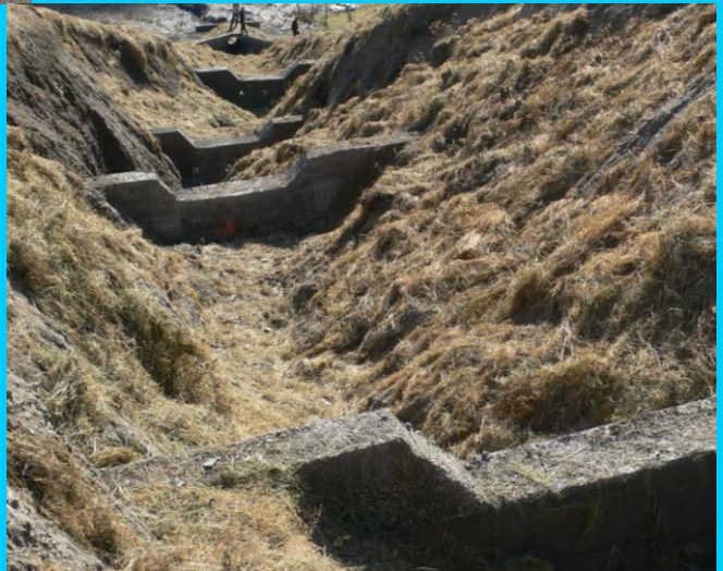
ПРОТИВОЭРОЗИОННО-СЕЛЕВЫЕ БАРРАЖИ В СЕЛЕ ДЖВАРБОСЕЛИ (МТАТУШЕТИ АХМЕТСКОГО РАЙОНА). РАБОТА ВЫПОЛНЕНА ПРИ ФИНАНСИРОВАНИИ МИРОВОГО БАНКА. РУКОВОДИТЕЛЬ ПРОЕКТА, ПРОФЕССОР ГИВИ ГАВАРДАШВИЛИ
